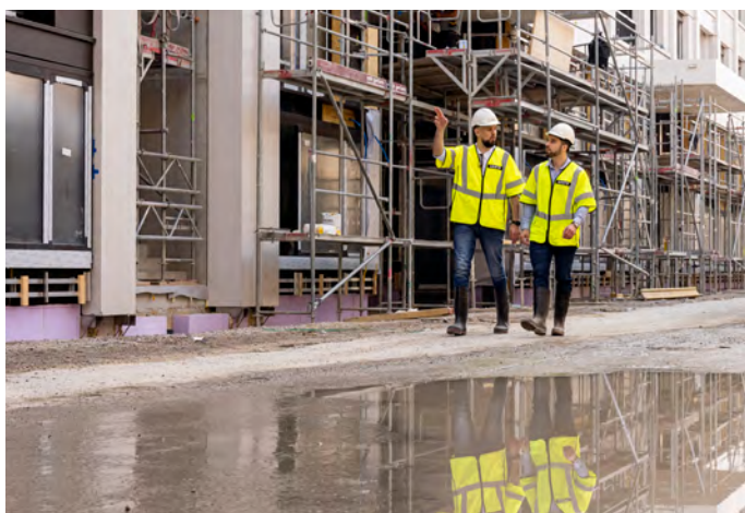
Heute Grossbaustelle, morgen das «Atelier 14»: Tobias und Lukas sind schon mitten in der Planung.
